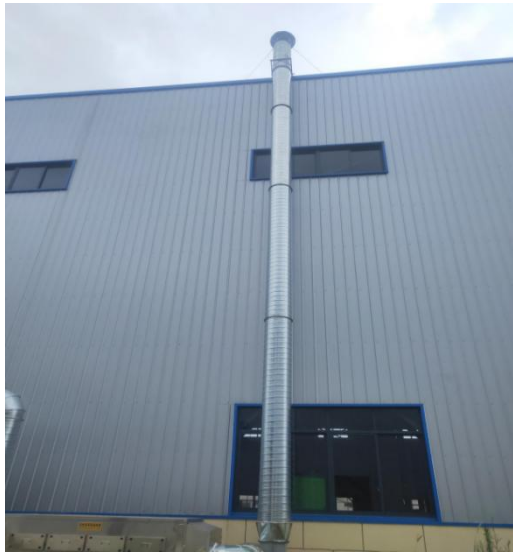
涂漆废气排气筒
